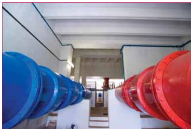
Il sistema GIS implementato da Acqualatina ha permesso di realizzare in tempo breve un sistema di gestione informatizzato completo della cartografia delle infrastrutture da coordinare.
