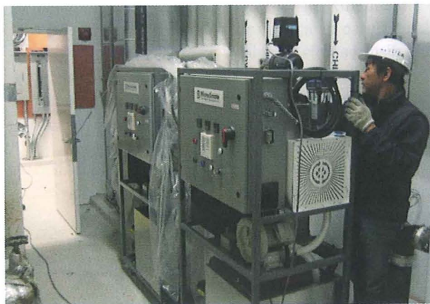
Qui sopra e in alto, tecnici impegnati nel posizionamento e nel collaudo di dispositivi Microclimate
